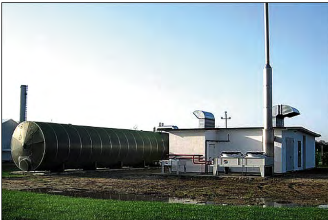
BHKW-Anlage mit 150 m 3 Pufferspeicher, zur Beheizung einer Gewächshausanlage. Foto: Rainer Bonnhoff
